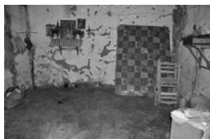
Piso de tierra al interior de la vivienda
